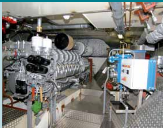
Die MTU-Hauptmaschine leistet 1.320 kW. Gelöscht wird in Bugmotoren- und Maschinenraum mit CO2
